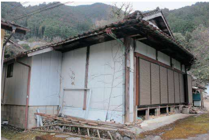
平成24年に被災した空き家
