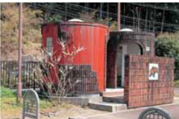
改修が必要な横手公園のトイレ
