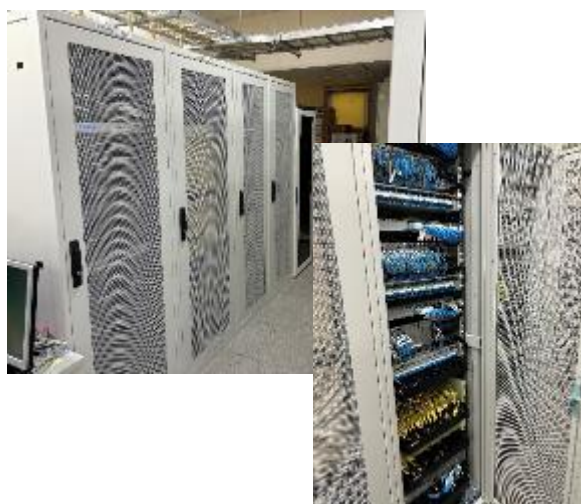
増強されたセンター設備
