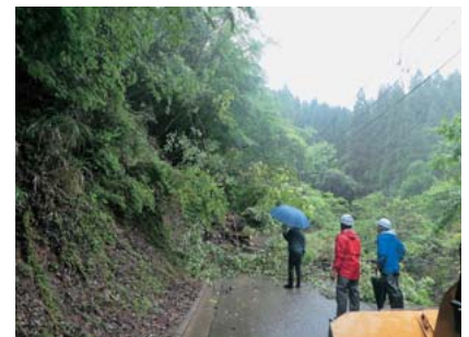
瀬目線の崩土
