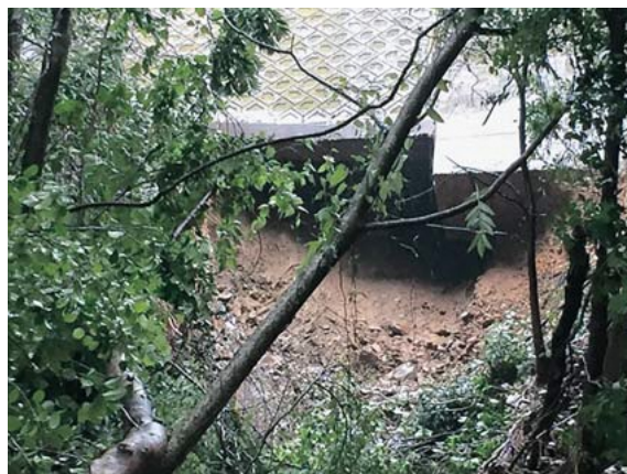
村道梶原線災害の様子
