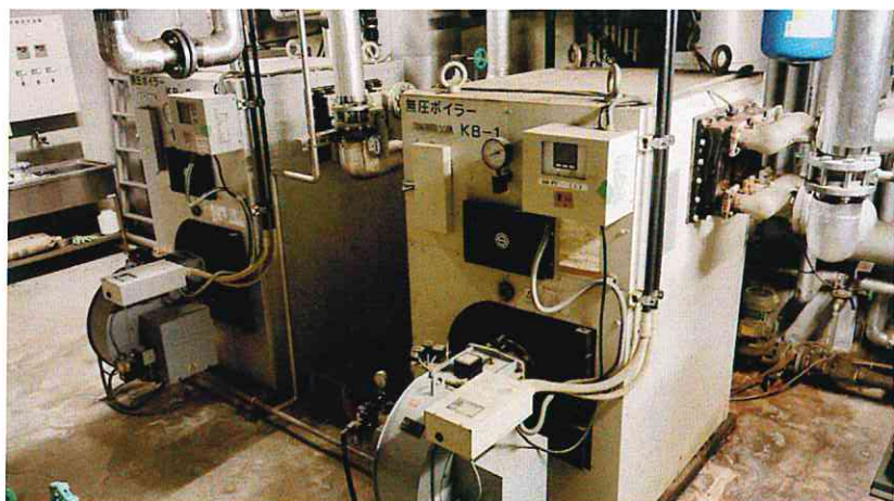
老朽化している温泉館のボイラー
