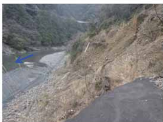
三方谷地区 道路復旧（着手前）
