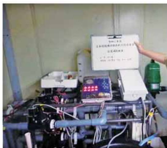
設備の導入（液肥混入機）
