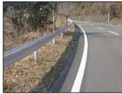
ガードレールの更新
