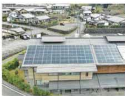
PPAによる発電設備 （五木村役場庁舎）
