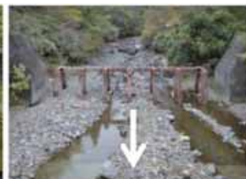
流木撤去後(R6年11月時点)
