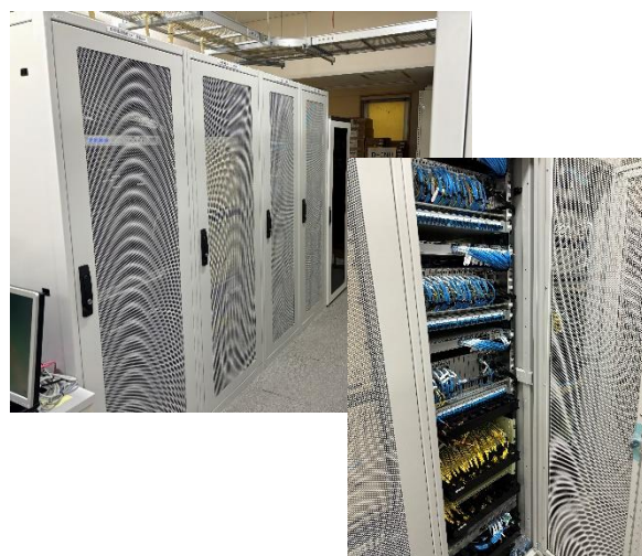
増強されたセンター設備
