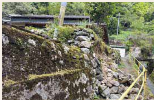
里道に崩れた石垣
