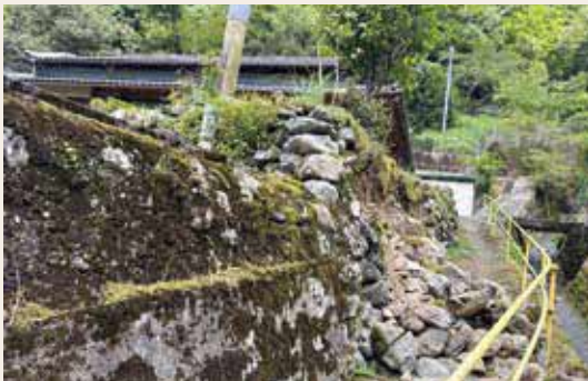
里道に崩れた石垣
