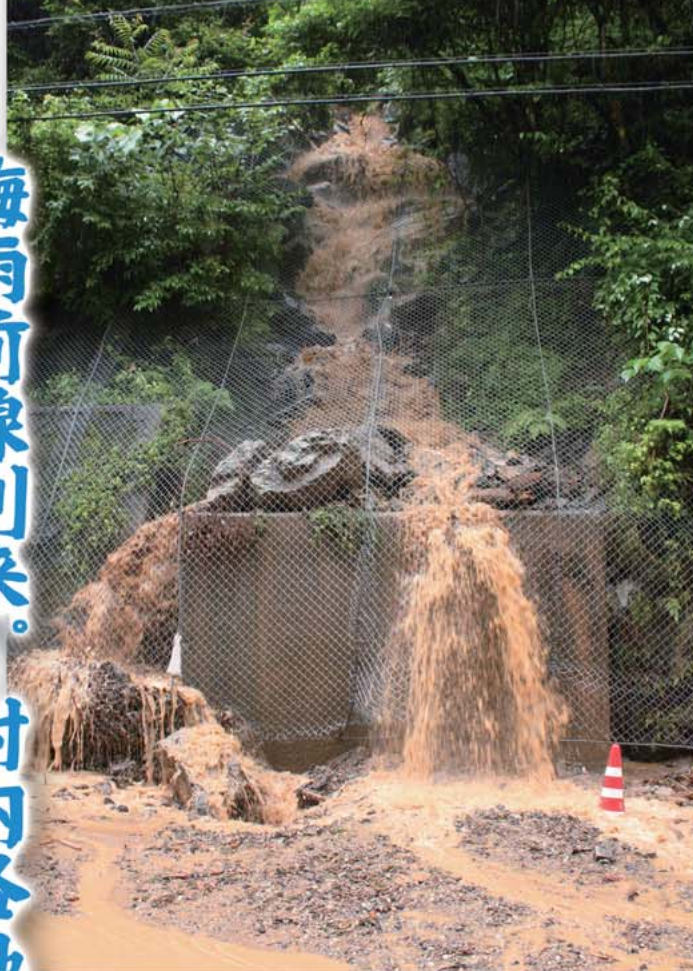
砂利・泥混じりの水が道路一面に流出(県道・元井谷付近)
